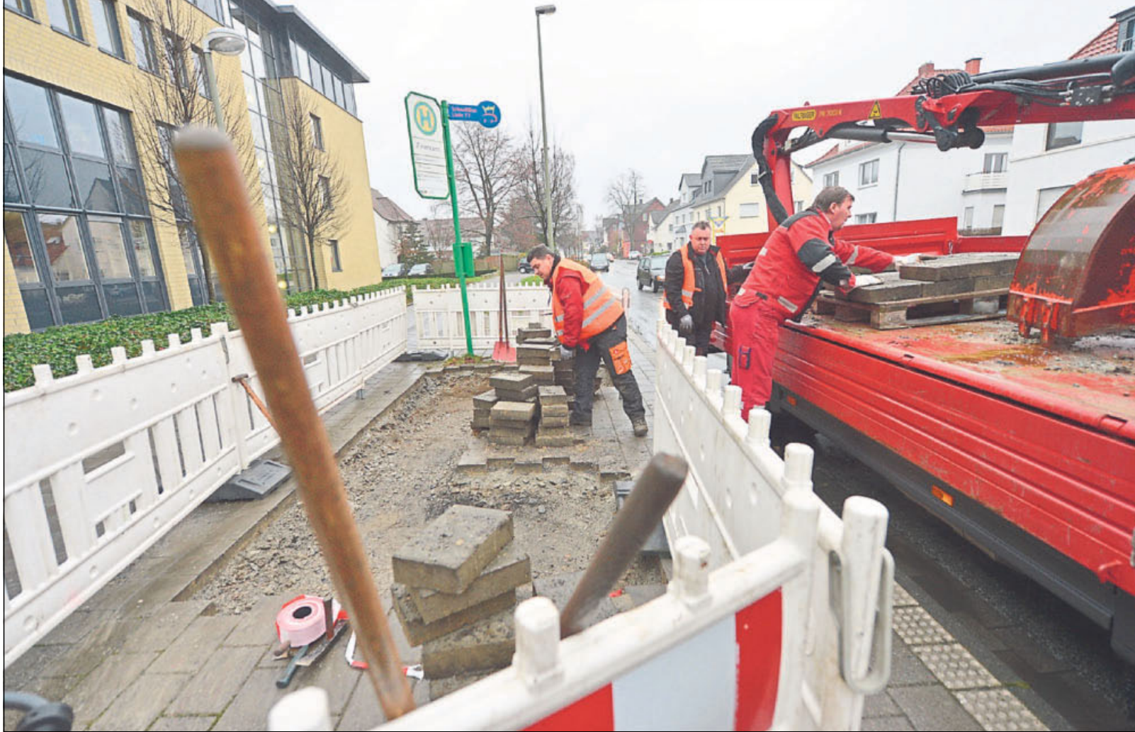
Das Gütersloher Finanzamt hat seit gestern kein Buswartehäuschen mehr. Die Stadt aber beeilt sich, Ersatz zu schaffen. Schon Anfang
