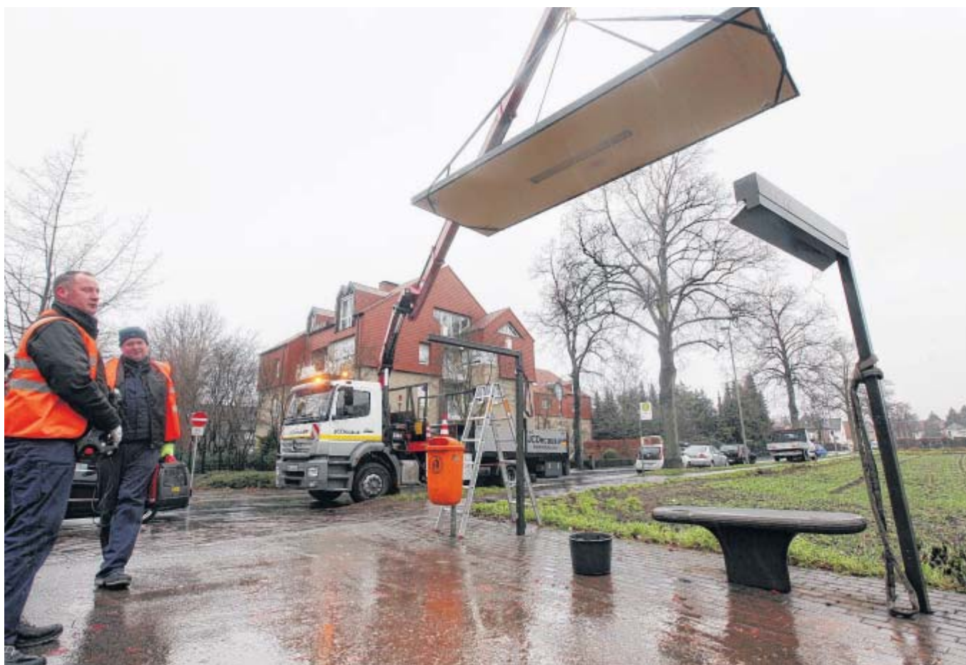
Demontage: Mitarbeiter der Firma JCDecaux waren gestern damit beschäftigt, die ersten Wartehallen abzubauen. Sie werden verschrottet. Das gilt auch für diese Anlage am Westfalenweg/Ecke Brockweg.
