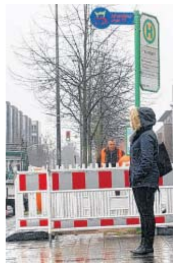
Eben war hier noch ein Häuschen: Jetzt wartet der Fahrgast vorm Finanzamt im Regen auf den Bus.
